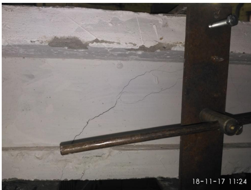
Рис. 8. Похила тріщина у ребрі (балки без нормальних тріщин).
